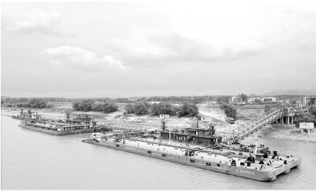
5月11日,中石化巴陵石化公司长江北尾码头提质改造项目工地,施工作业有序推进。作为长江岸线湖南段港口码头专项整治提质改造工程之一,该项目按《绿色港口等级评价标准》要求,将其提质改造为生态环保、资源节约、低碳安全的现代化码头。彭展杨杰摄
