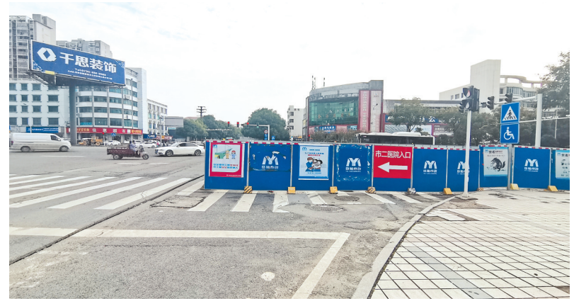
工地围挡挤占斑马线。
